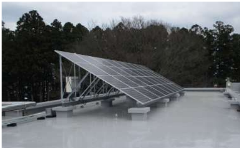
太陽光発電施設
