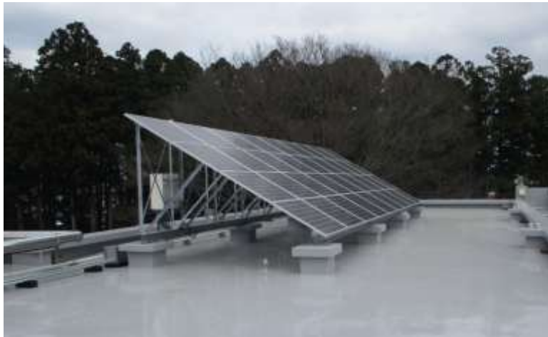
太陽光発電施設
