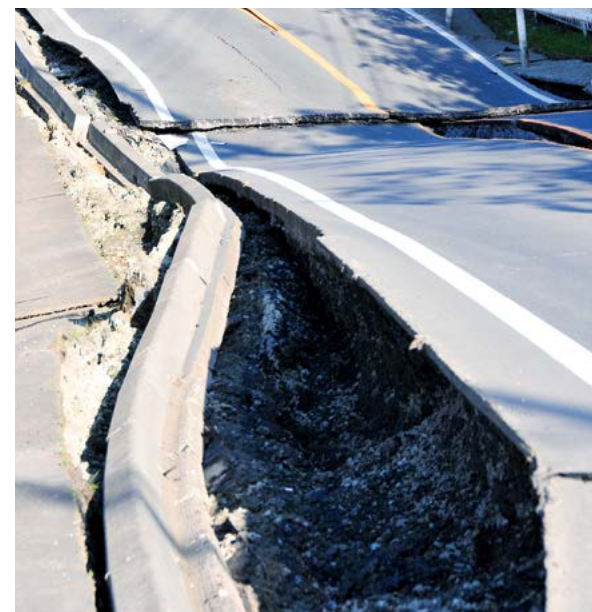
断裂・沈下した道路
