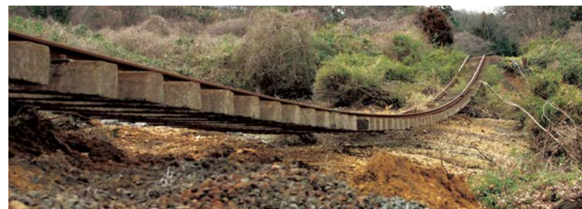
ため池が決壊し、宙づりになったひたちなか海浜鉄道湊線の線路
