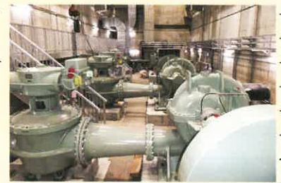
那珂川揚水機場ポンプ設備
