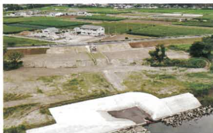
①那珂川揚水機場（新設）
