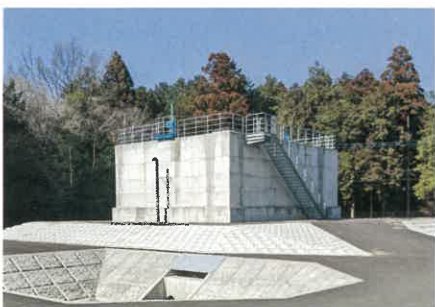
高根幹線（新設）（内原調圧水槽）
