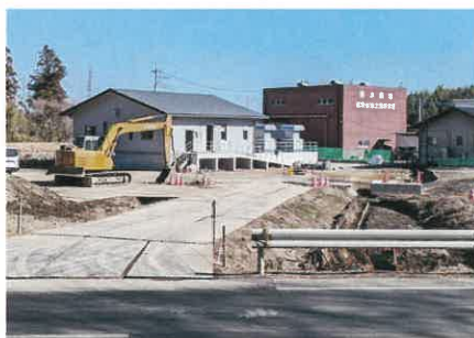
渡里揚水機場（改修）
