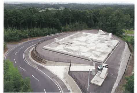
成沢吐水槽（新設）
