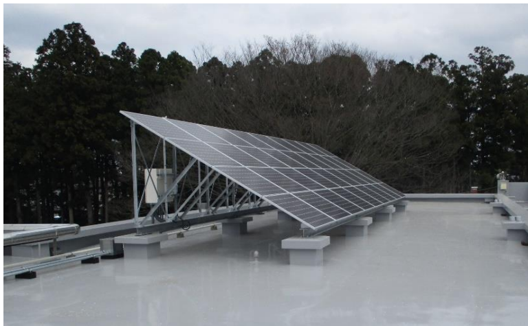
太陽光発電施設
