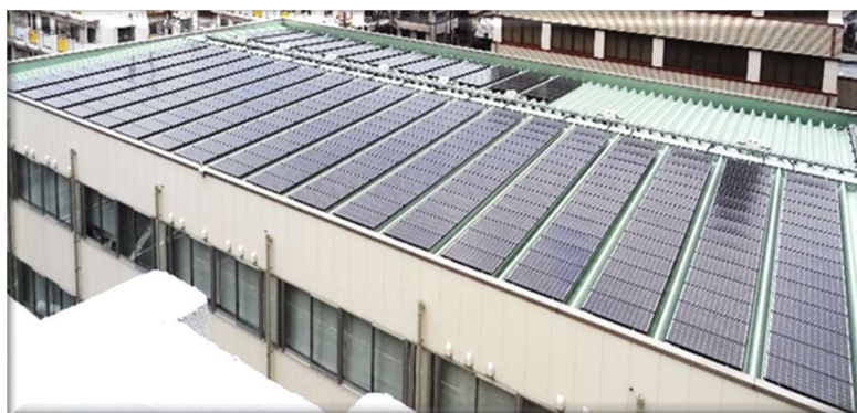
第3分庁舎の太陽光発電システム
