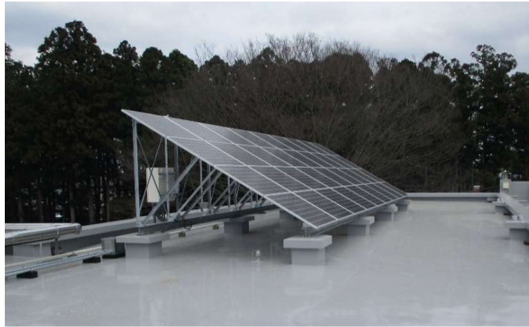
太陽光発電施設
