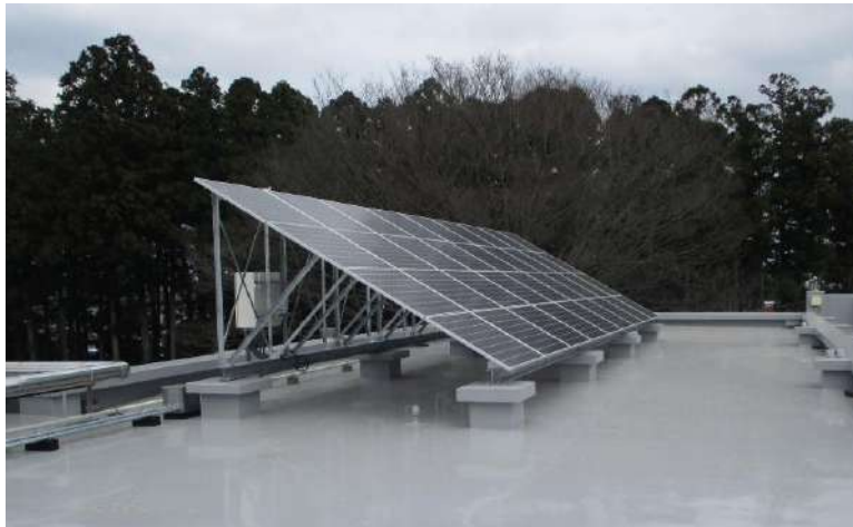
太陽光発電施設
