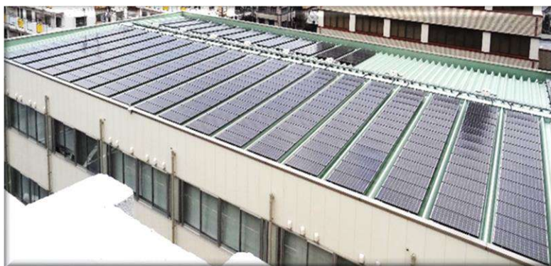
第3分庁舎の太陽光発電システム
