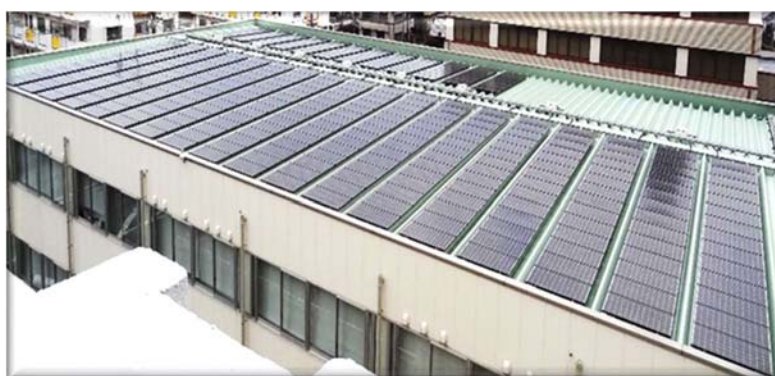
第3分庁舎の太陽光発電システム
