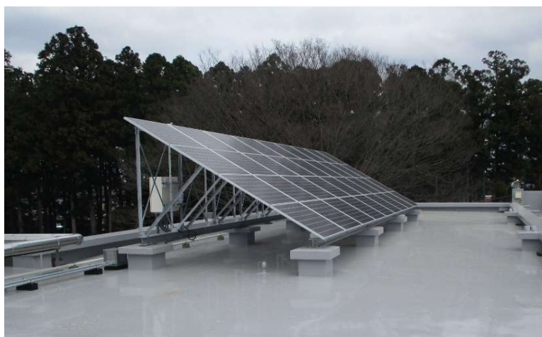
太陽光発電施設
