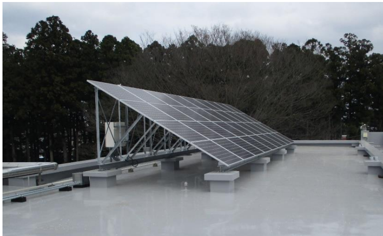
太陽光発電施設
