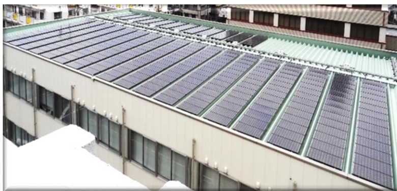
第3分庁舎の太陽光発電システム
