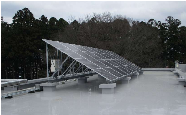
太陽光発電施設
