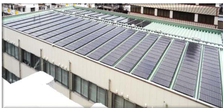
第3分庁舎の太陽光発電システム
