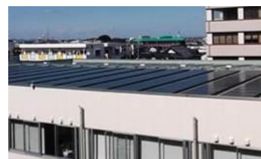
第3分庁舎の太陽光発電システム
