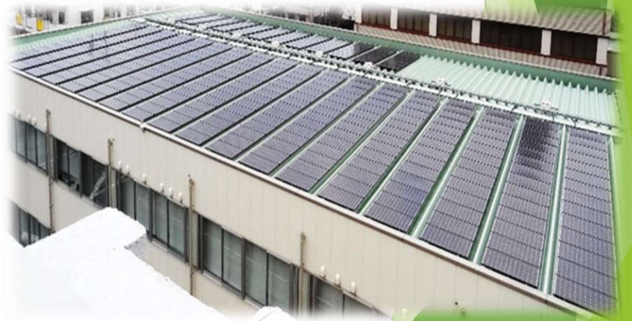
市役所第3分庁舎の太陽光パネル
