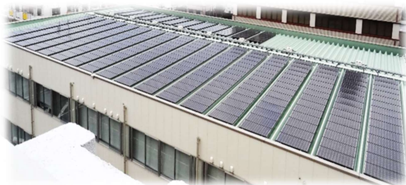
第3分庁舎の太陽光発電システム
