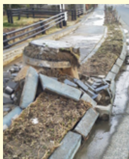
マンホール浮き上がり (田中後)
