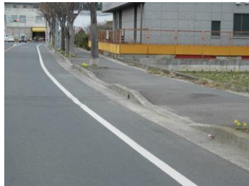
歩道が波を打っている
