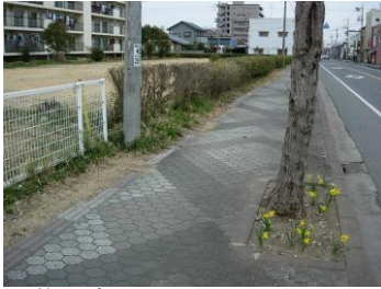
誘導用ブロックの位置が悪い上に草が覆われて位置が確認しづらい
