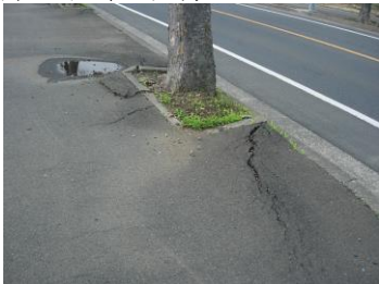
街路樹の根により歩道が隆起している
