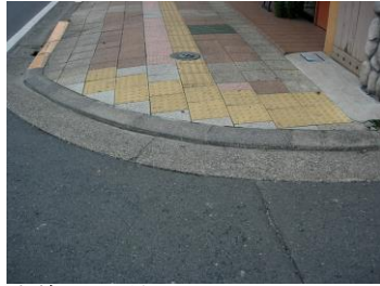
車道との段差が4cm以上あるところがある
