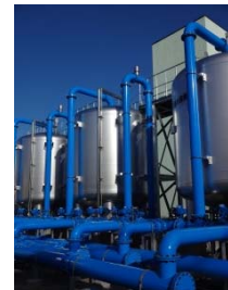
図 23 上ヶ砂配水場の 新設ろ過設備
