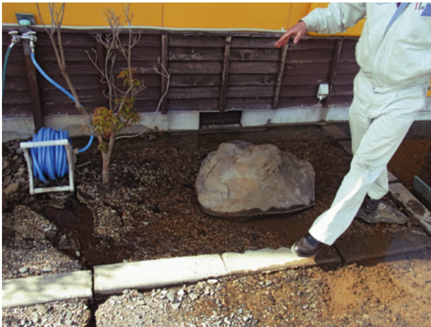
宅地内の漏水
