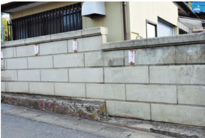
二次災害を防ぐため危険の張り紙がされた塀
