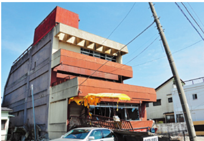
1階の駐車場が圧壊した店舗
