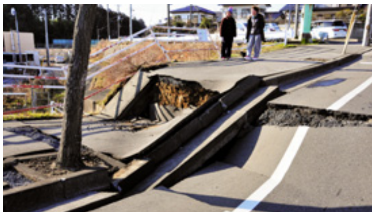
道路の断裂・沈下（中根地内）
