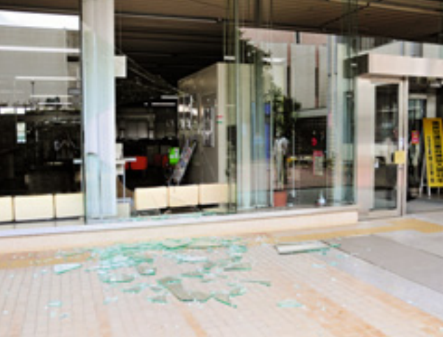
市役所本庁舎の壁面ガラスの破損
