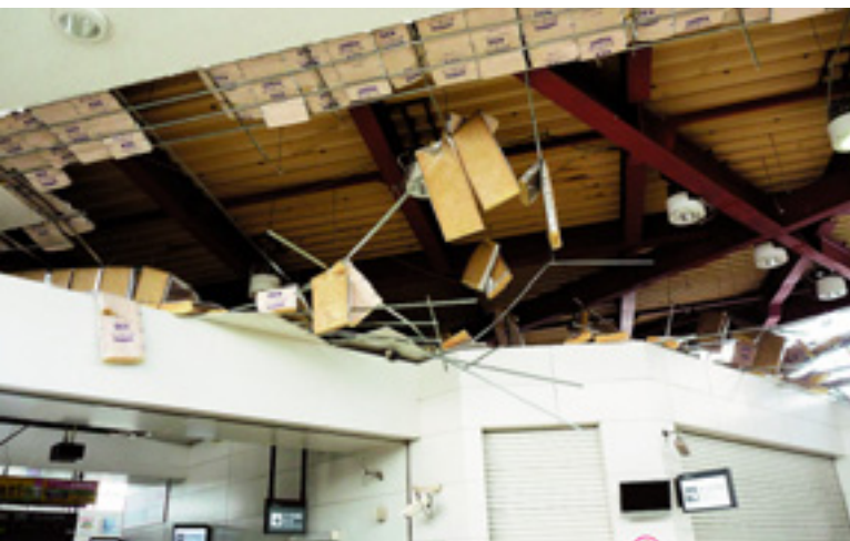
天井が崩落したJR勝田駅東西自由通路
