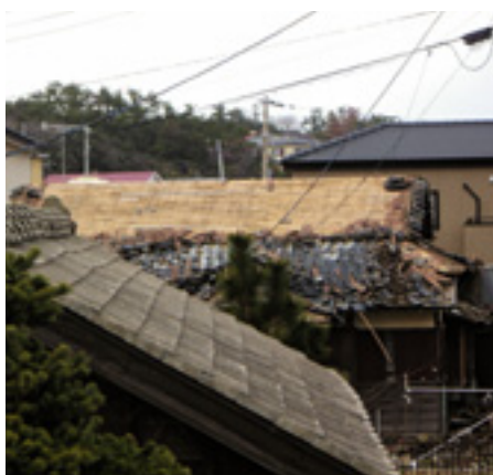
地震による瓦の崩落(阿字ヶ浦町地内)
