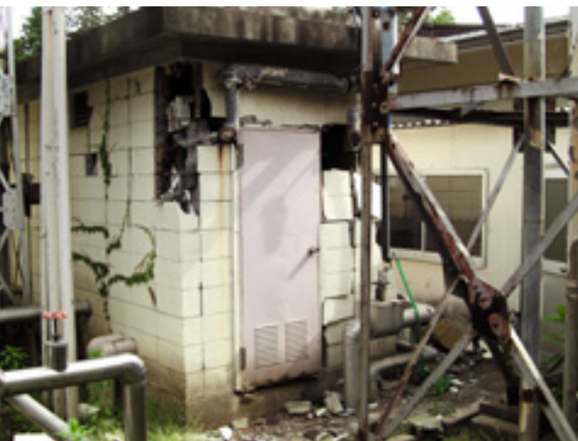
馬渡荘ボイラー室の破損
