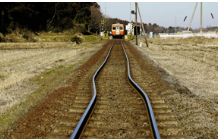
レールが湾曲し緊急停車したひたちなか海浜鉄道湊線（中根地内）
