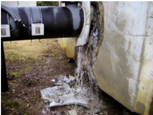
浄水施設の接合部破損（上坪浄水場）
