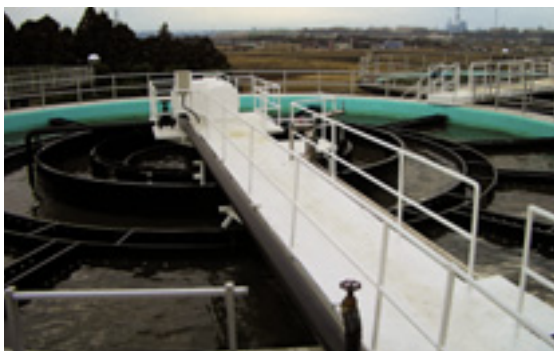
トラフ（とい）が脱落した沈澱池（上坪浄水場）
