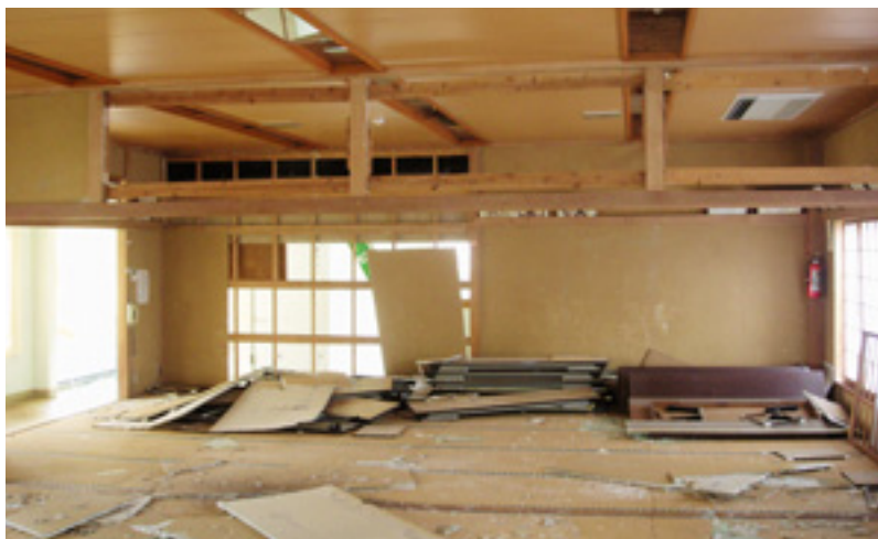
天井や内壁が破損した磯崎公民館内
