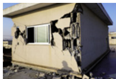
平磯小学校校舎屋上の機械室外壁の崩落
