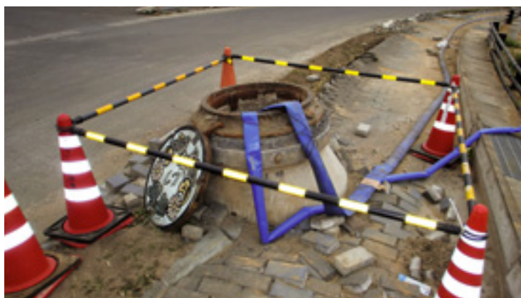
マンホールの隆起（田中後地内）
