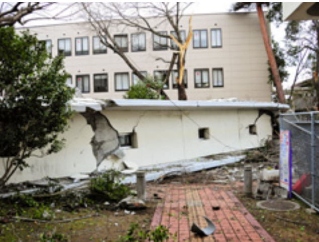
倒壊した市役所の高さ38mの煙突
