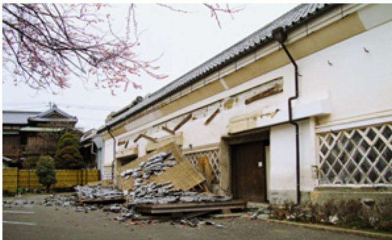
ひさしや壁が破損したふるさと懐古館
