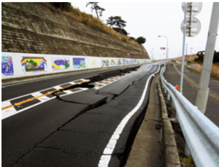
道路の亀裂や陥没（市道湊1-1号線）
