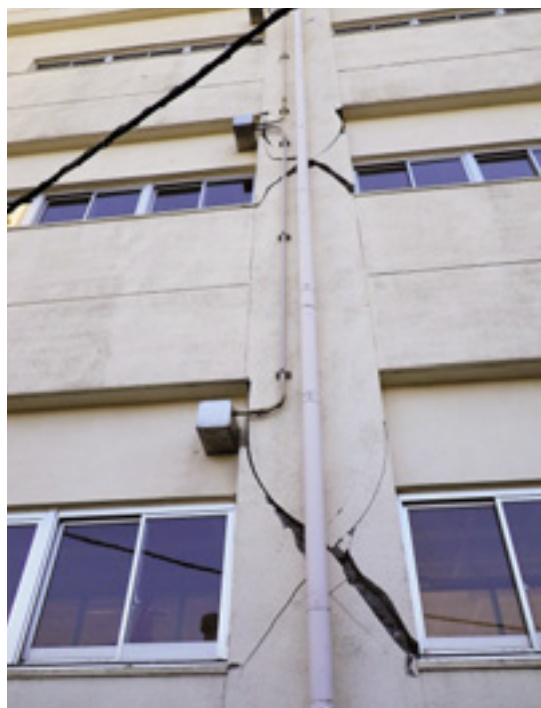
平磯小学校校舎の柱の亀裂
