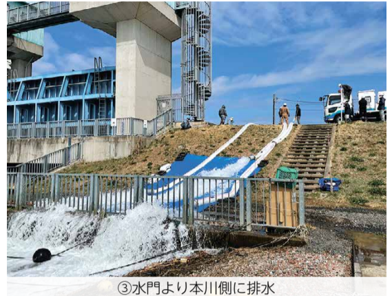
③水門より本川側に排水
