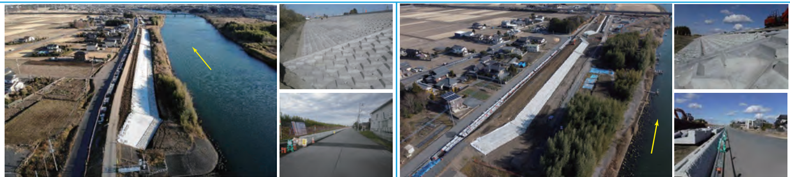
↑勝倉地区（上流工区）上記写真は上空からの写真。右側上段は連節ブロックの施工，右側下段は堤脚水路の施工状況。【令和4年1月時点】 ↑勝倉地区（下流工区）上記写真は上空からの写真。右側上段は連節ブロックの施工，右側下段は堤脚水路の施工状況。【令和4年1月時点】
