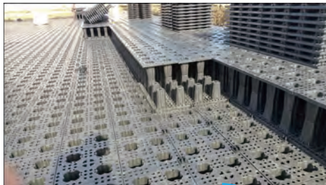
グラウンドの下にある雨水貯留施設
