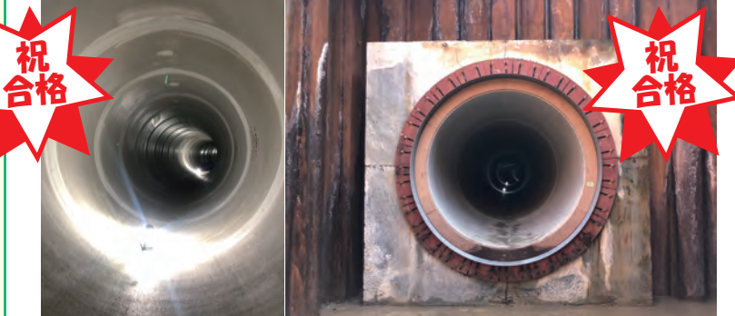
▲管きょ布設完了：管きょ布設状況 ▲立坑からの管きょ布設状況
