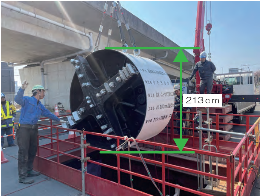
人間とほぼ同じ大きさのシールドマシン。設置する雨水管が大きいため機械も大きくなります。
