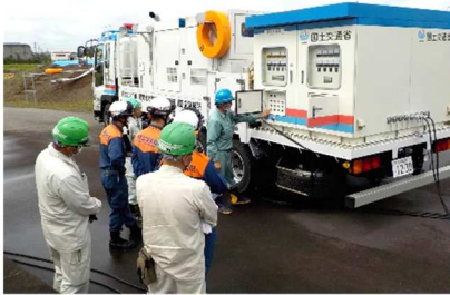
排水ポンプ車の操作
