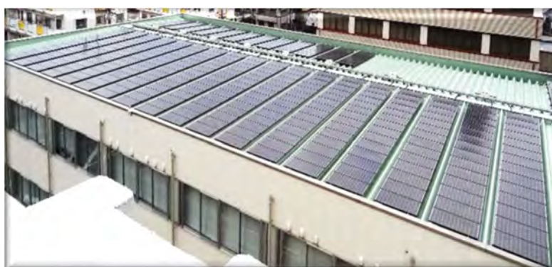
第3分庁舎の太陽光発電システム
