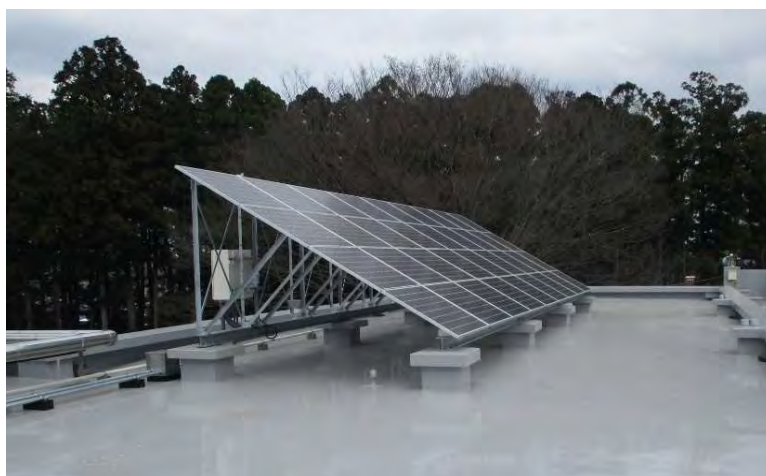
太陽光発電施設
