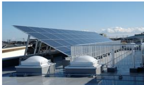
那珂湊第二小学校の太陽光発電システム
