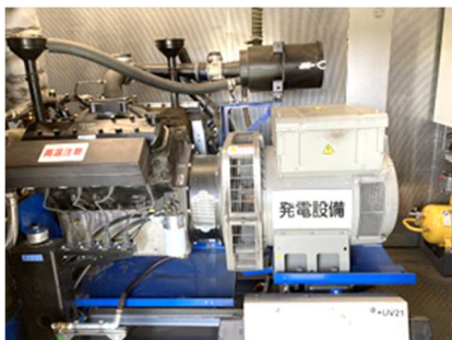
バイオマスガス発電の 発電システム
